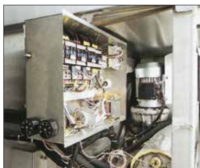
Cuadro eléctrico LP-67
